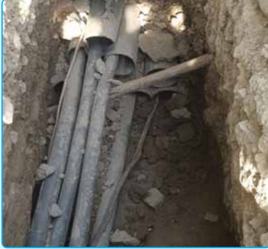
बिजुली underground, वडा नं. ४
