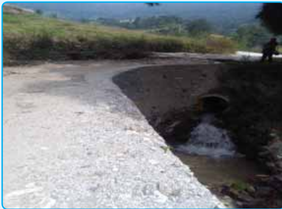
बडा कार्यालयबाट दुलालगाड जाने मोटर बाटो ढलान तथा साईड बाल निर्माण, बडा नं. १
