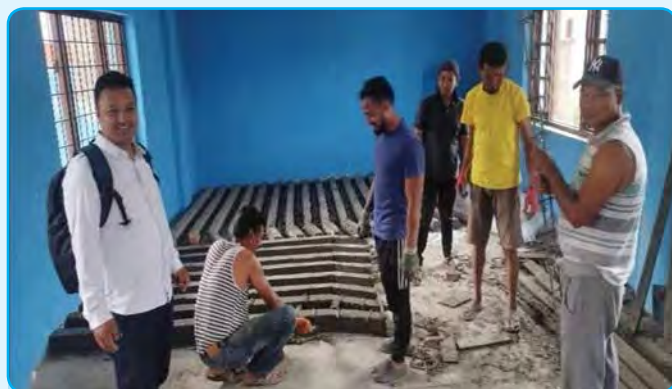
प्रधानमन्त्री रोजगार कार्यक्रम अन्तर्गत टोखा ४ मा लागत साभेदारीमा सार्वजनिक जग्गा संरक्षणका लागि समेन्ट पोल बनाउँदै श्रमिकहरु
